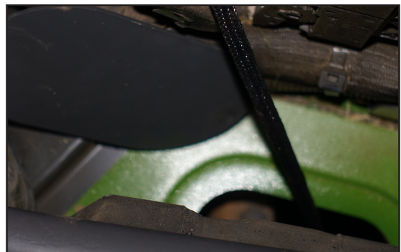
Abb. 24: Stecker X01A in Kabine verlegt
