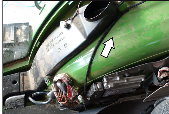
Abb. 25: Stecker X01A zur Zentralelektrik führen
